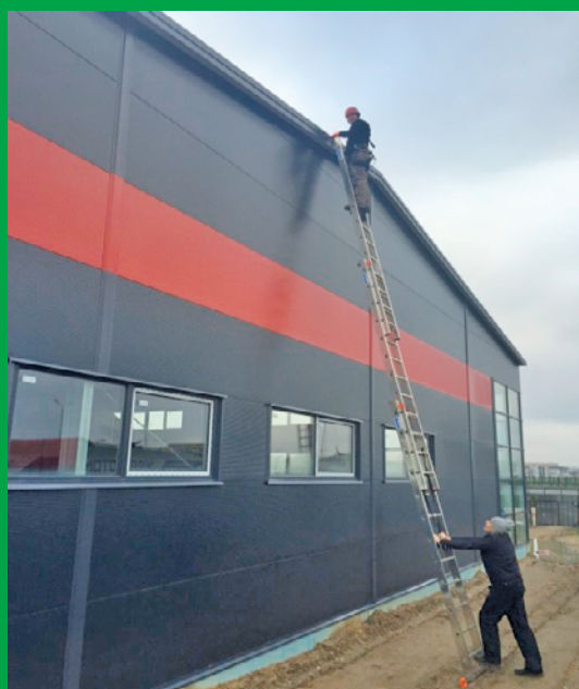
Stanowisko pracy przed zakupem podnośnika
